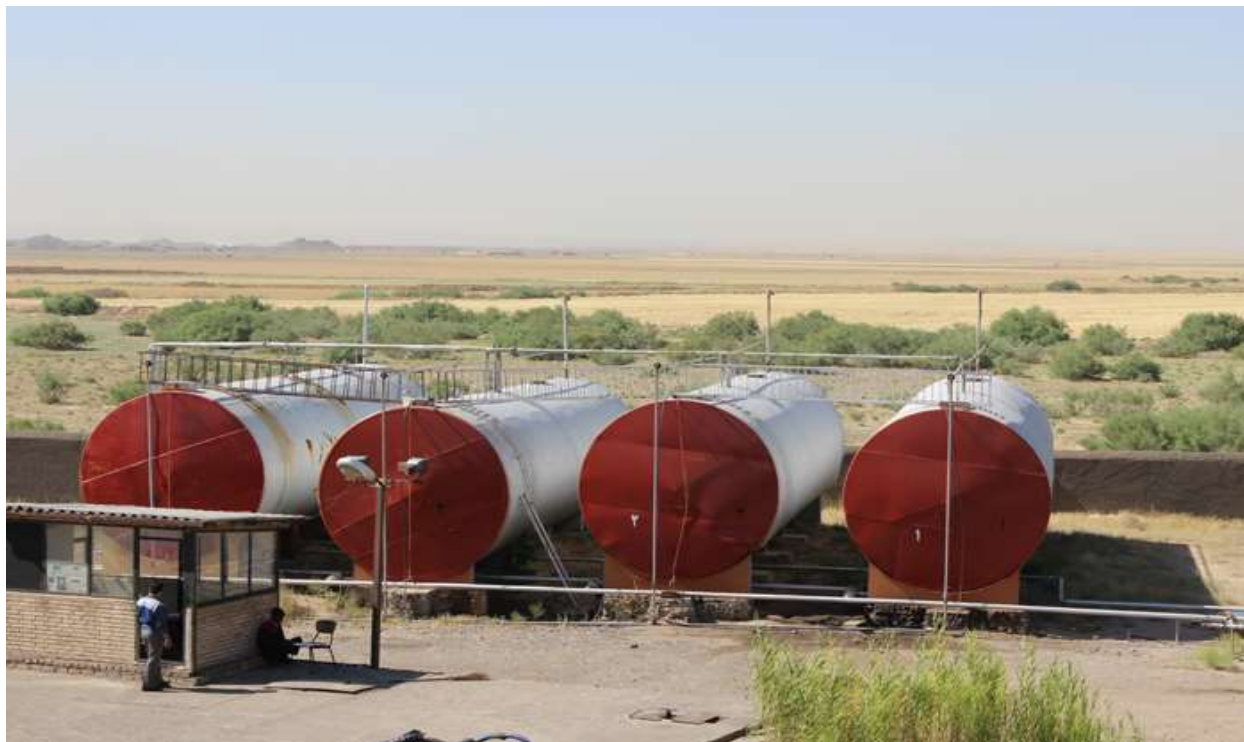
شکل 1 - نمای مخازن روغن در ضلع شرقی کارخانه
